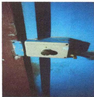
Foto 3: Sustrucción de chapa
